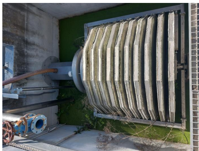
Imagen nº 1.- Instalación de filtración (a sustituir)
