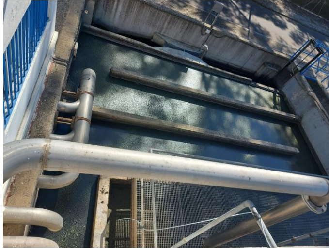
Imagen nº 2.- Laberinto de cloración
