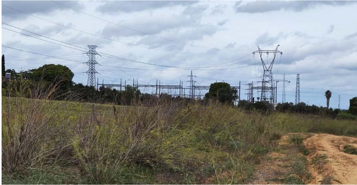
Fotografía 3. Vista de la SET "Aljarafe 66/15 kV" (propiedad de E-Distribución Redes Digitales, S.L.).
