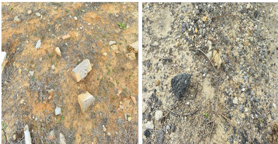
Fotografía 8. Suelo alterado como resultado de las obras en la carretera SE-40, en los terrenos donde se ubica íntegramente la Planta Solar.
