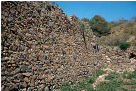
Restos del muro de cierre del jardín delantero.
