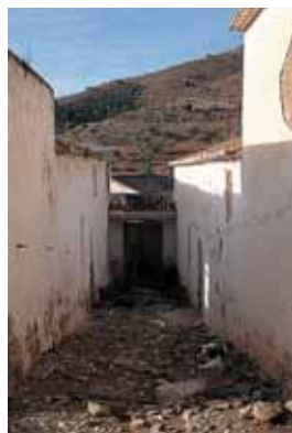
Calle entre los dos bloques que acogen dependencias de servicio y transformación.
