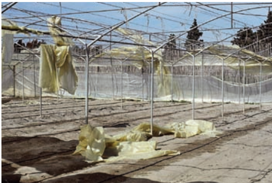
Fig. 56.- Efecto del viento en el plástico de un invernadero de tubo galvanizado
